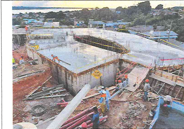
FOTO 19: VACEO DE LOSA MACIZA, LOSA ALIGERADA, NERVADA F'C=210 KG/CM2 DEL CENTRO CULTURAL SEGUNDO NIVEL
