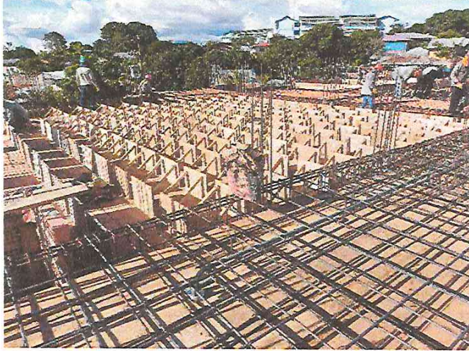
FOTO 13: COLOCACION DE ACERO EN LOSA MACIZA Y VIGAS DEL CENTRO CULTURAL SEGUNDO NIVEL
