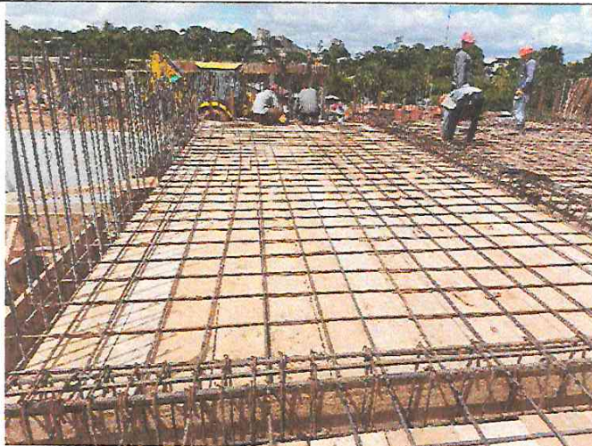
FOTO 12: COLOCACION DE ACERO EN LOSA MACIZA Y VIGAS DEL CENTRO CULTURAL SEGUNDO NIVEL
