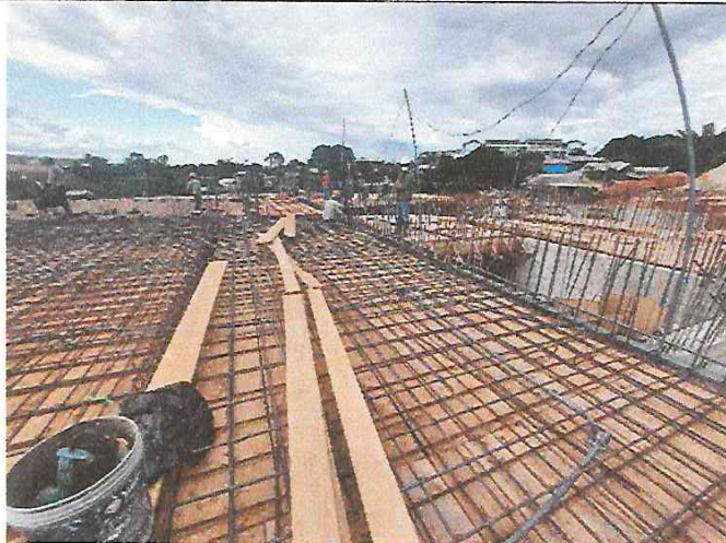
FOTO 14: COLOCACION DE ACERO EN LOSA MACIZA Y VIGAS DEL CENTRO CULTURAL SEGUNDO NIVEL
