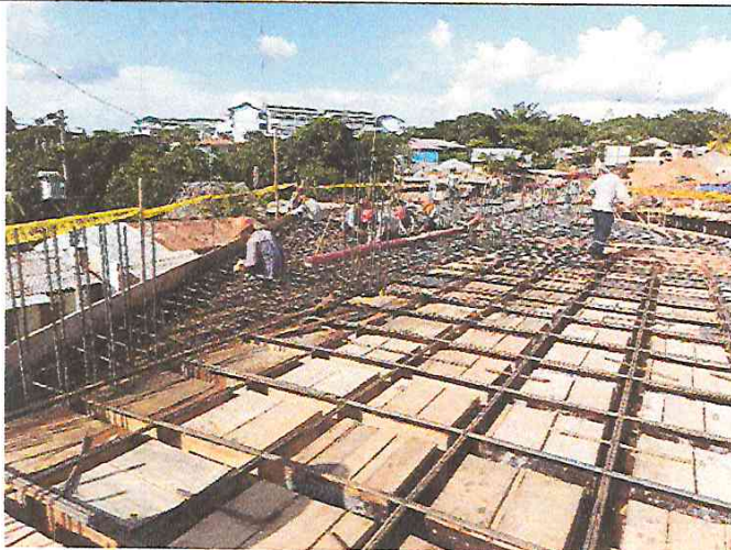
FOTO 15: COLOCACION DE ACERO EN LOSA MACIZA Y VIGAS DEL CENTRO CULTURAL SEGUNDO NIVEL
